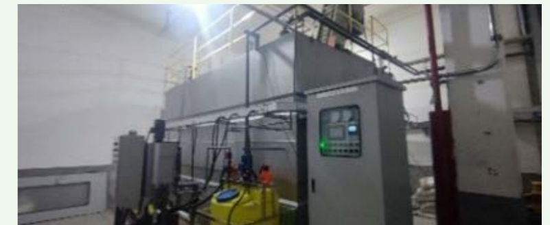
上海創新中心污水處理站
